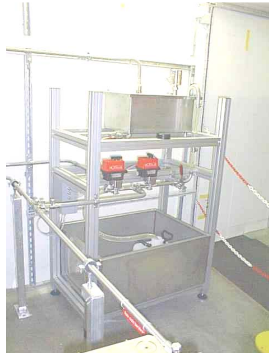
Abb. 8: Die automatische Befüllanlage im Innern des Speicherrings
